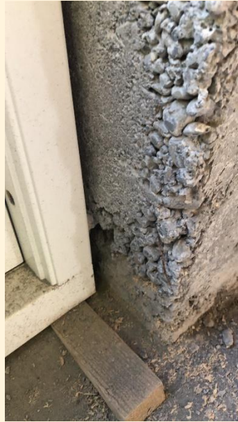
Búið að setja karm í án þess að laga skemmdir
