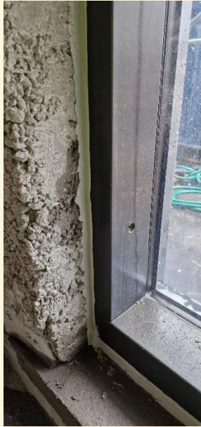
Steypuhreiður sem hefur ekki verið lagað
